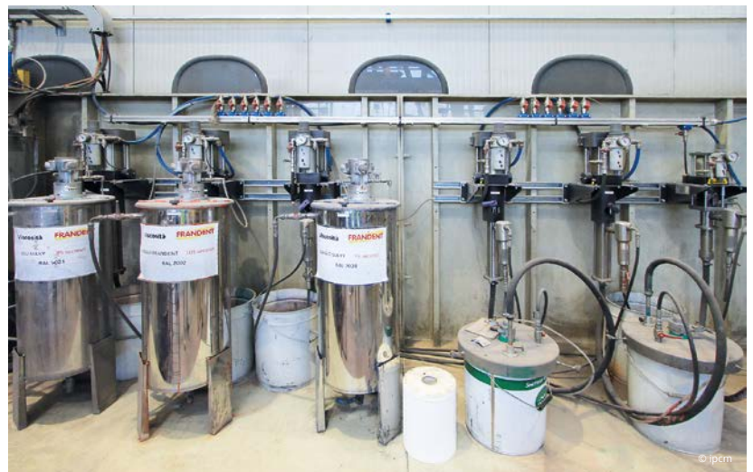
Dall’alto al basso: il tunnel di pretrattamento a 4 stadi; i componenti primerizzati; la centrale vernici.
