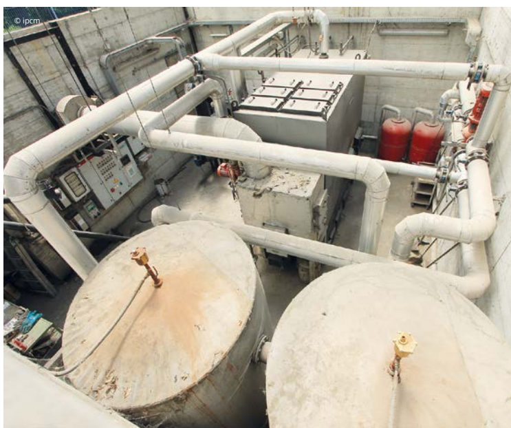
La centrale a biomassa.
