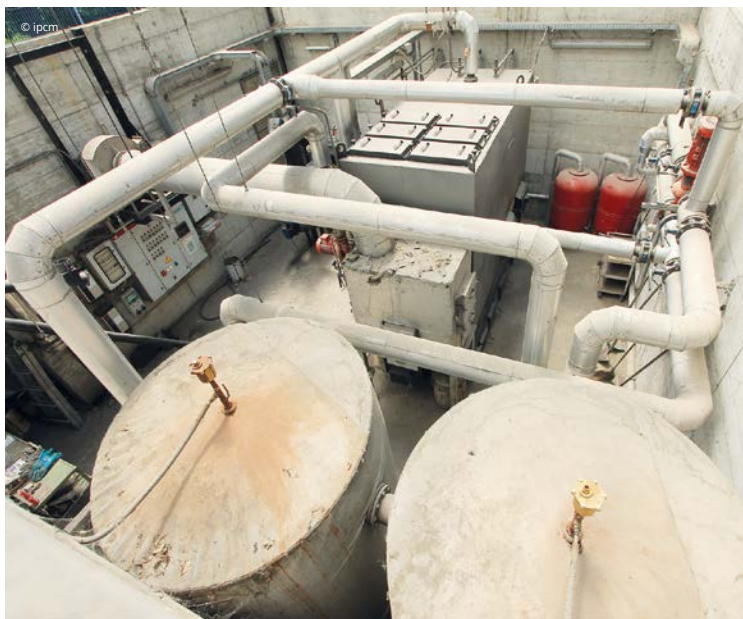
La centrale a biomassa.
