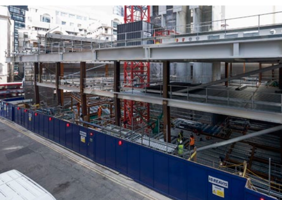
Zdjęcia dzięki uprzejmości Bourne Steel Ltd.
