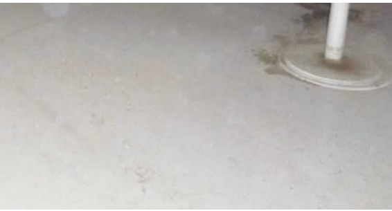
Película de 600-750 micras de Dura-Plate UHS tras casi nueve años de inmersión en crudo/agua
